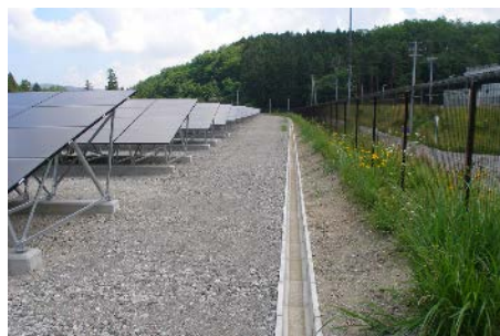
<適切な柵塀設置の事例>
