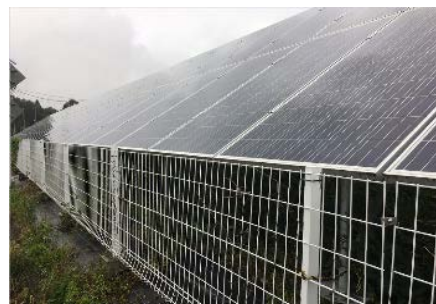
<不適切な柵塀設置の事例>
