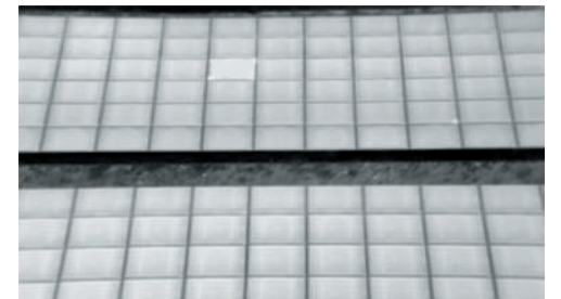
モジュール ガラス割れ
