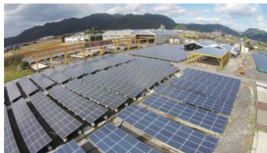
高圧太陽光/自社保有物件/岐阜県揖斐郡大野町
