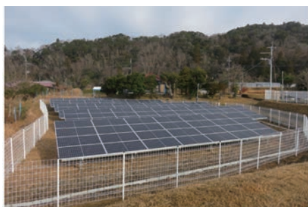
低圧太陽光発電所/千葉県君津市/権利物件/69.6kW/2021年1月連系
