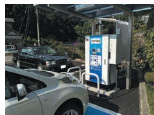
EV急速充電器
