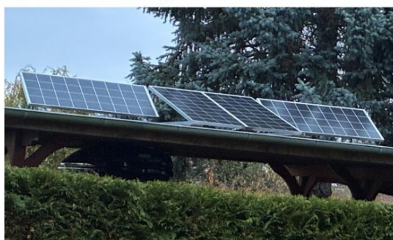
a) カーポート上の結晶シリコンモジュール
