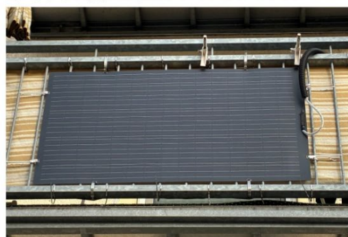
b) 手すりに設置されたフレキシブルモジュール
