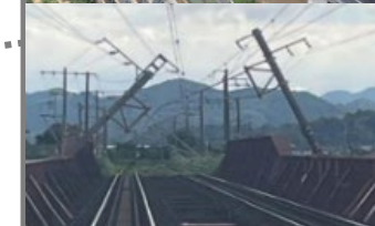
令和8年熊本地震の被害状況 (国土交通省ホームページから)
