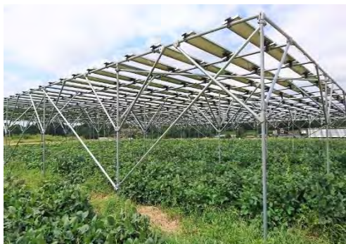
発電設備の外観
