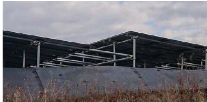
柵塀が未設置 また、標識も未設置
