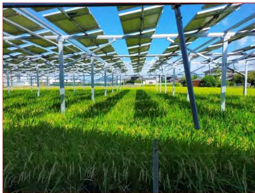
地区①の発電設備の外観
