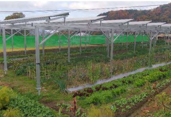
発電設備の外観
