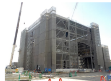
坂出バイオマス発電所（香川県坂出市）
