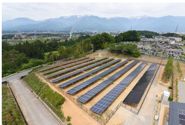
図表 58 リユース品を使用した発電所
