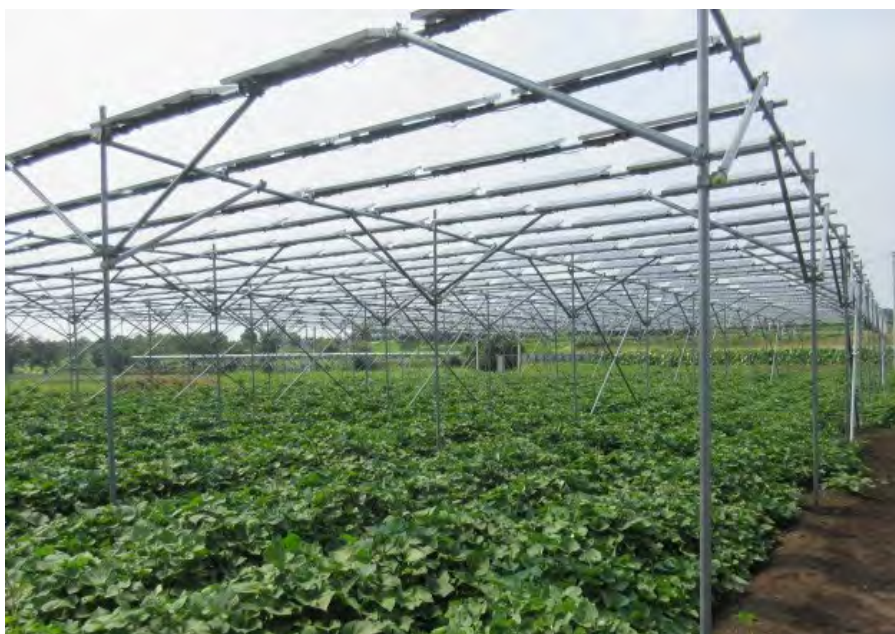
露地の畑の上部にパネルを設置
