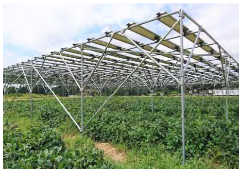
発電設備の外観
