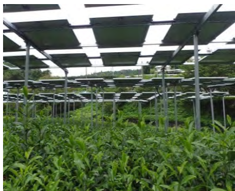
設置された太陽光パネル
