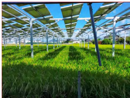
地区①の発電設備の外観
