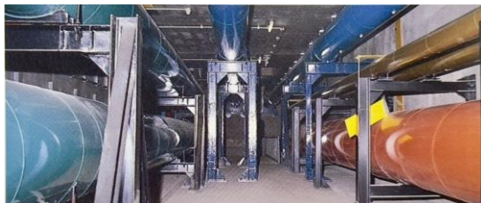
筑波研究学園都市の地域冷暖房共同溝
