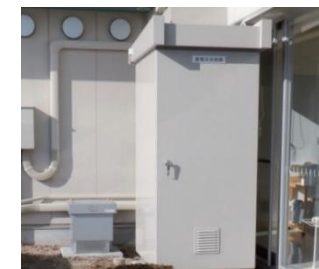
蓄電池 (駅東地域交流センター)
