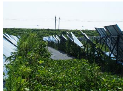
不十分な管理で放置されたパネル
