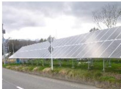
柵塀の設置されない設備
