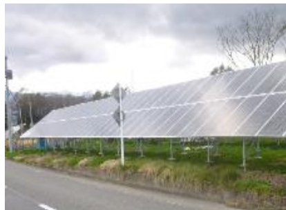
柵塀の設置されない設備
