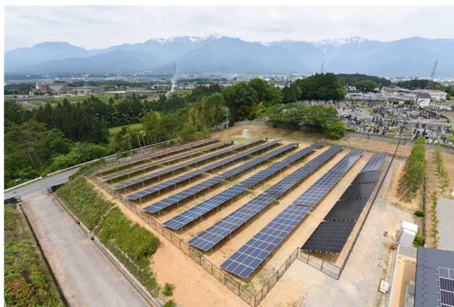
図表 56 リユース品を使用した発電所
