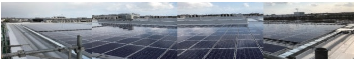
太陽光パネル
