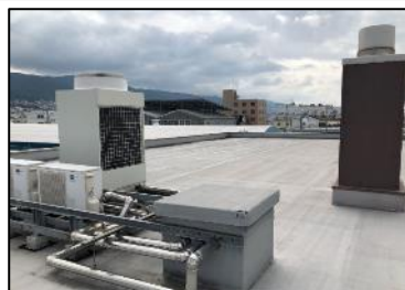
東大阪市東事業所 パネル設置箇所
