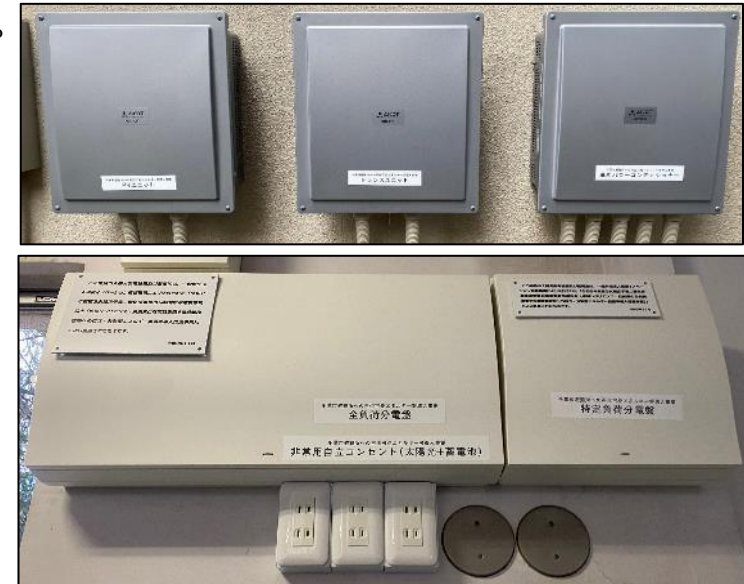
千葉市立千城台西中学校 設置設備 上段) パワーコンディショナ 下段) 非常用コンセント盤
