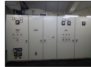
愛媛県久万高原町久万浄化センター 受電盤
