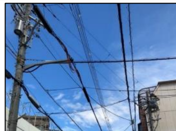
東大阪市西保健センター 電力引き込み箇所
