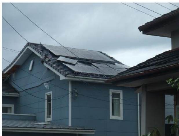
写真 2-4 住宅に設置された太陽光発電設備の地震被害事例 (出典：太陽光発電所ネットワーク提供)
