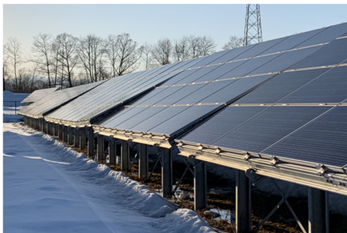
図 5-8 太陽光発電設備の凍上被害の一例
