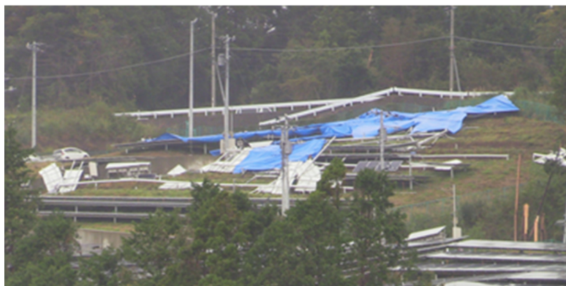
写真 2-5 傾斜地設置型太陽光発電設備の強風被害事例 写真提供：PVeye
