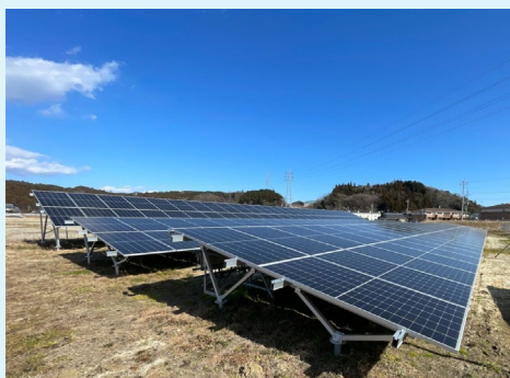
太陽光発電所
