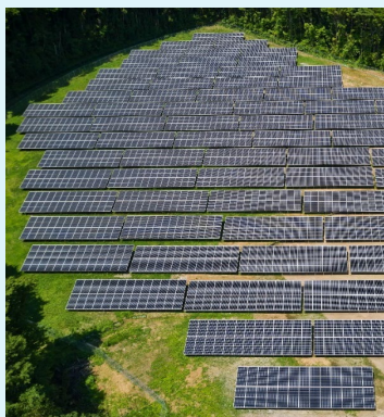
千葉若葉太陽光発電所
