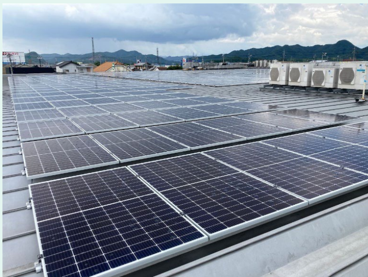
太陽光発電設備
