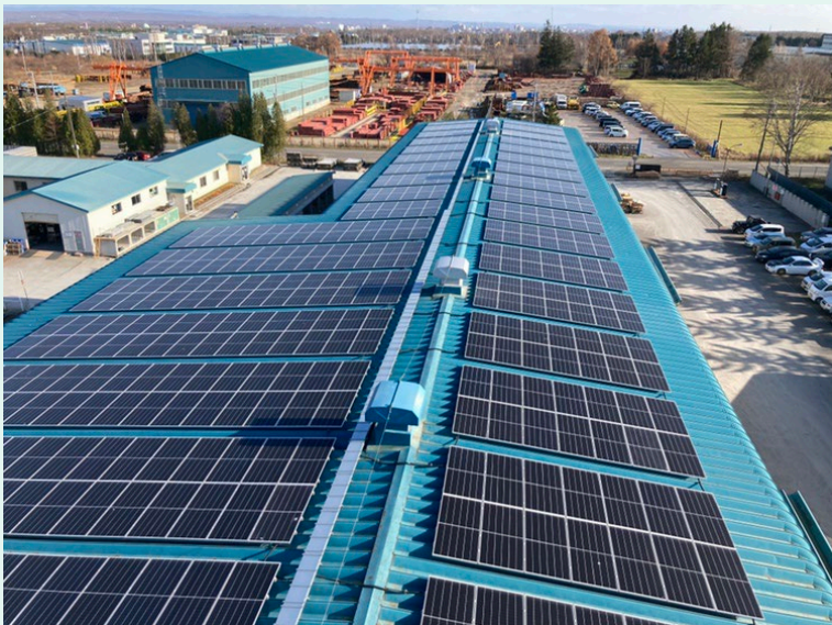
太陽光発電設備
