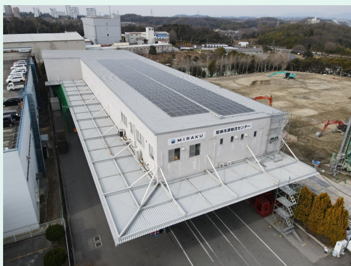
太陽光発電設備
