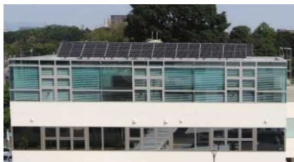
再生可能エネルギー（太陽光）設備
