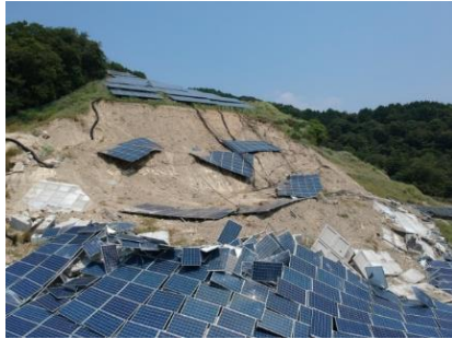
土砂崩れで生じた崩落
