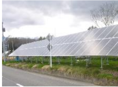
柵塀の設置されない設備
