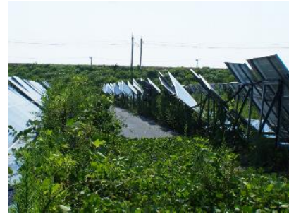
不十分な管理で放置されたパネル
