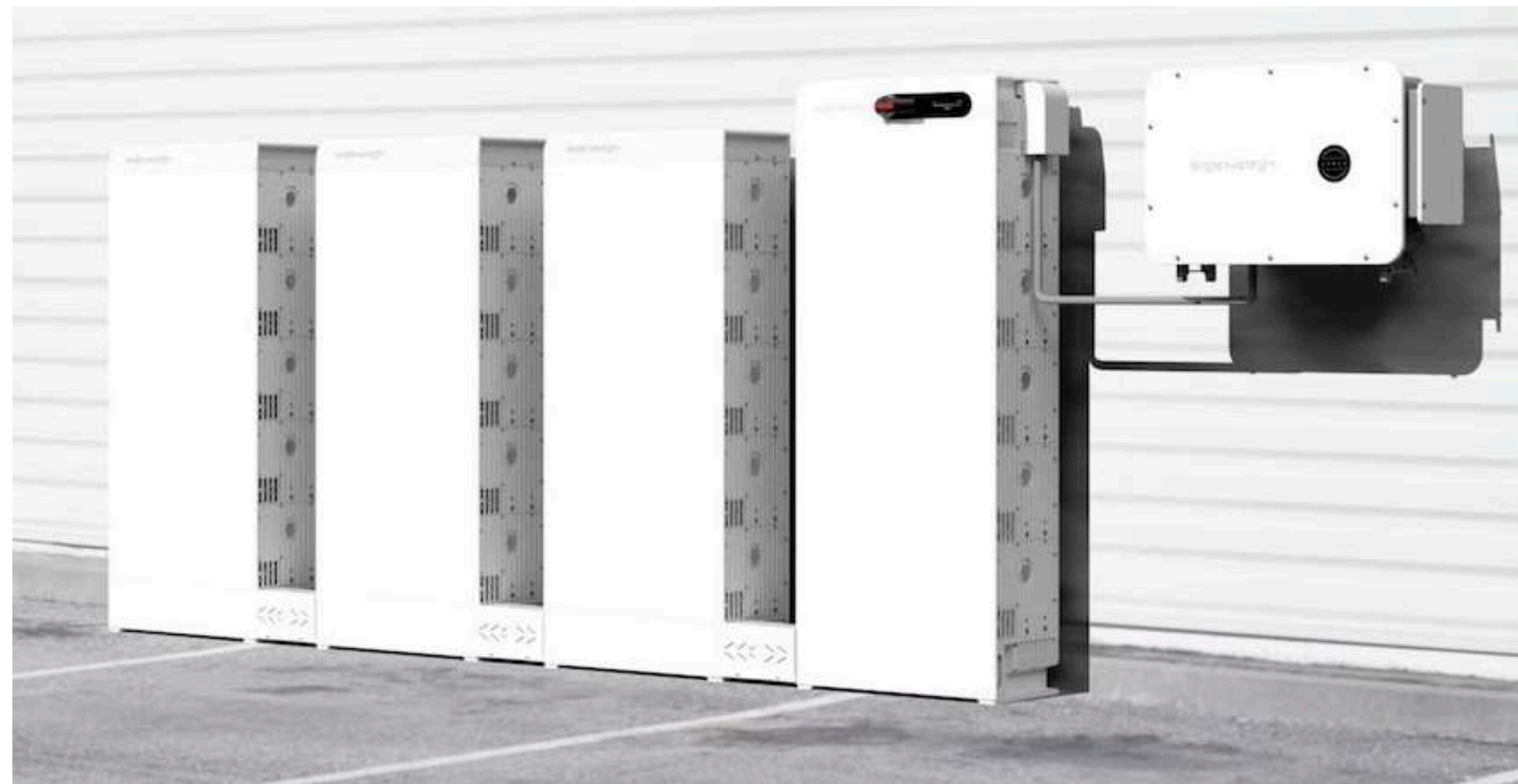
低圧系統蓄電池
