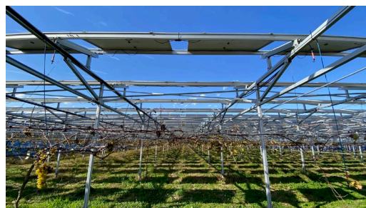
開所した営農型太陽光発電設備の様子
