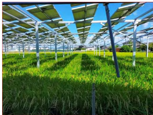
地区①の発電設備の外観
