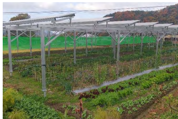
発電設備の外観
