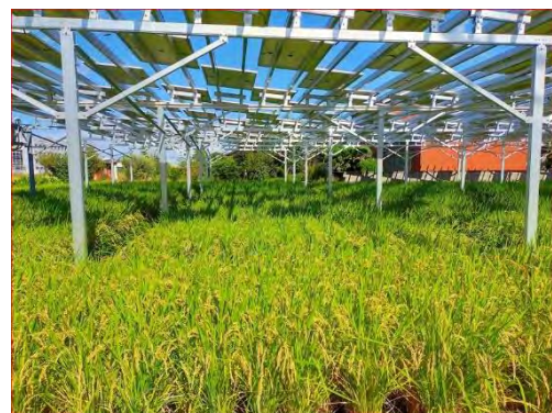
地区②の発電設備の外観
