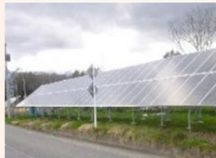
柵堀が設置されない設備
