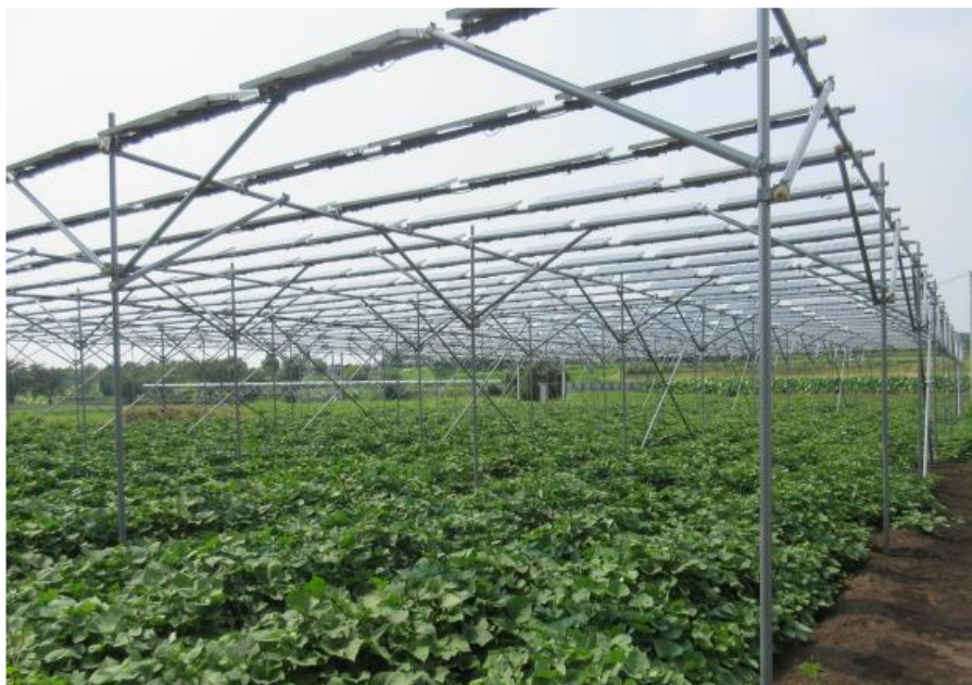
露地の畑の上部にパネルを設置
