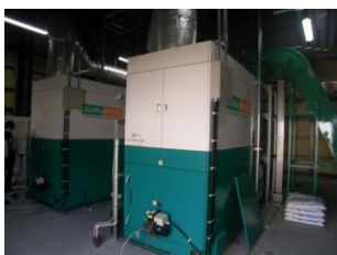
チップボイラー
