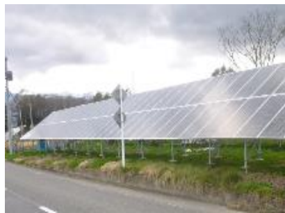
柵塀の設置されない設備
