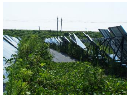
不十分な管理で放置されたパネル
