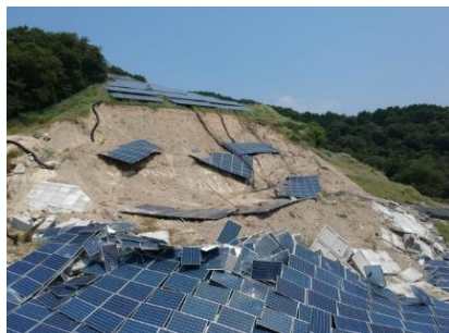
土砂崩れで生じた崩落
