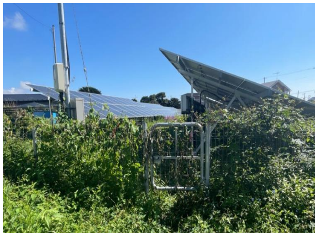
管理不十分な状態で下草に覆われたパネル
