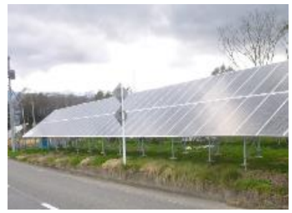
柵の設置されない設備
