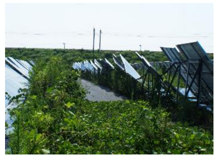
不十分な管理で放置されたパネル
