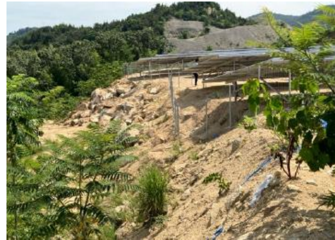
盛土が大きく崩落した太陽光発電設備
