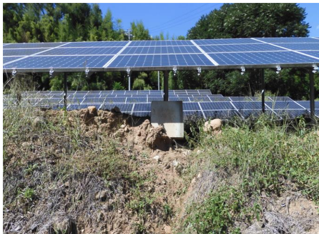
基礎が露出し浮いている太陽光発電設備
