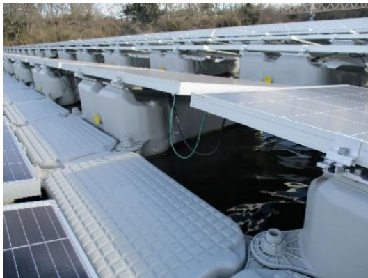
写真12-1 余長を考慮した配線の例
