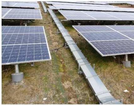
写真12-1 ラックによる配線の例
