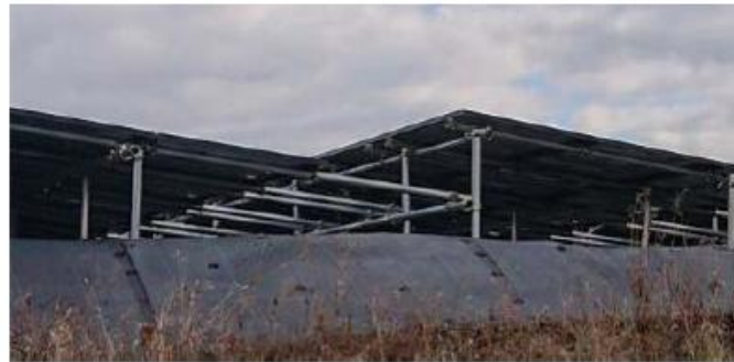
柵塀が未設置 また、標識も未設置
