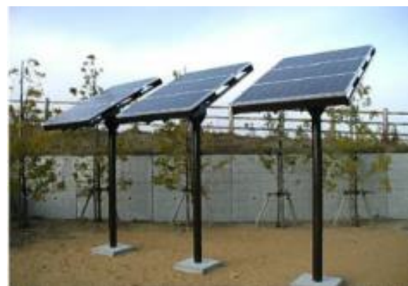
実証予定の既存発電設備（一部）
