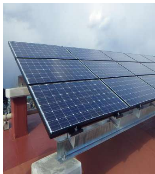
太陽光発電設備の導入例
