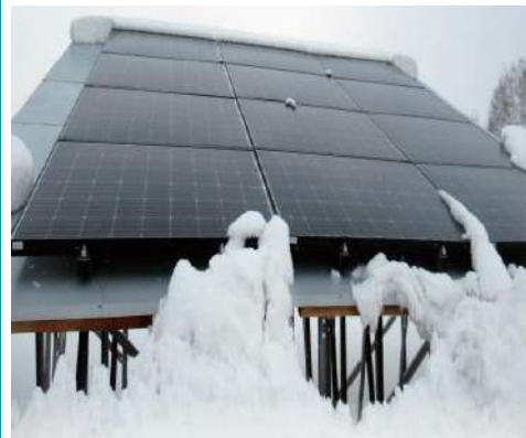
融雪機能付き太陽光発電設備
