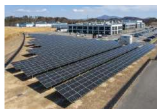
環境創造センターへの太陽光発電設備（自家消費型）の導入
