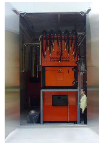
バイオマスボイラーの導入例
