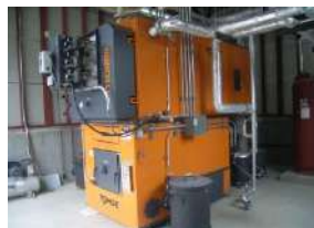
木質バイオマスボイラー
