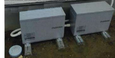
個人向け蓄電池設備
