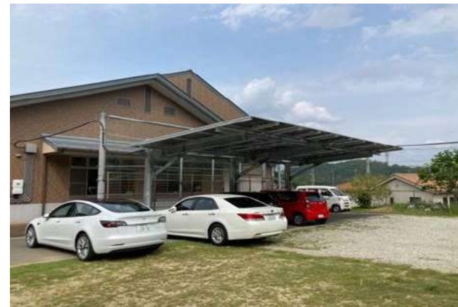
コミュニティセンターへの太陽光発電設備（カーポート型）の導入例
