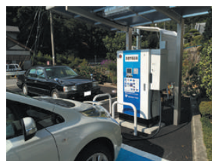
EV急速充電器
